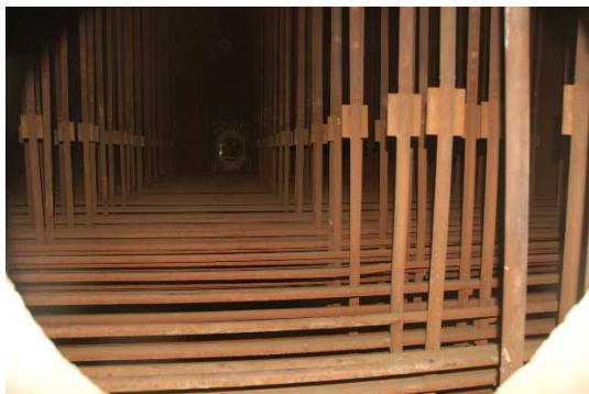
Forrcsövek a kazánban
