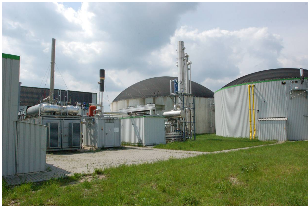
2. kép: Biogáz erőmű, Schwandorf
